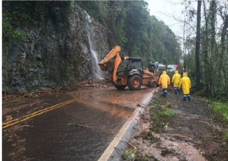
Prioridades incluem estruturas para contenção de deslizamentos.
