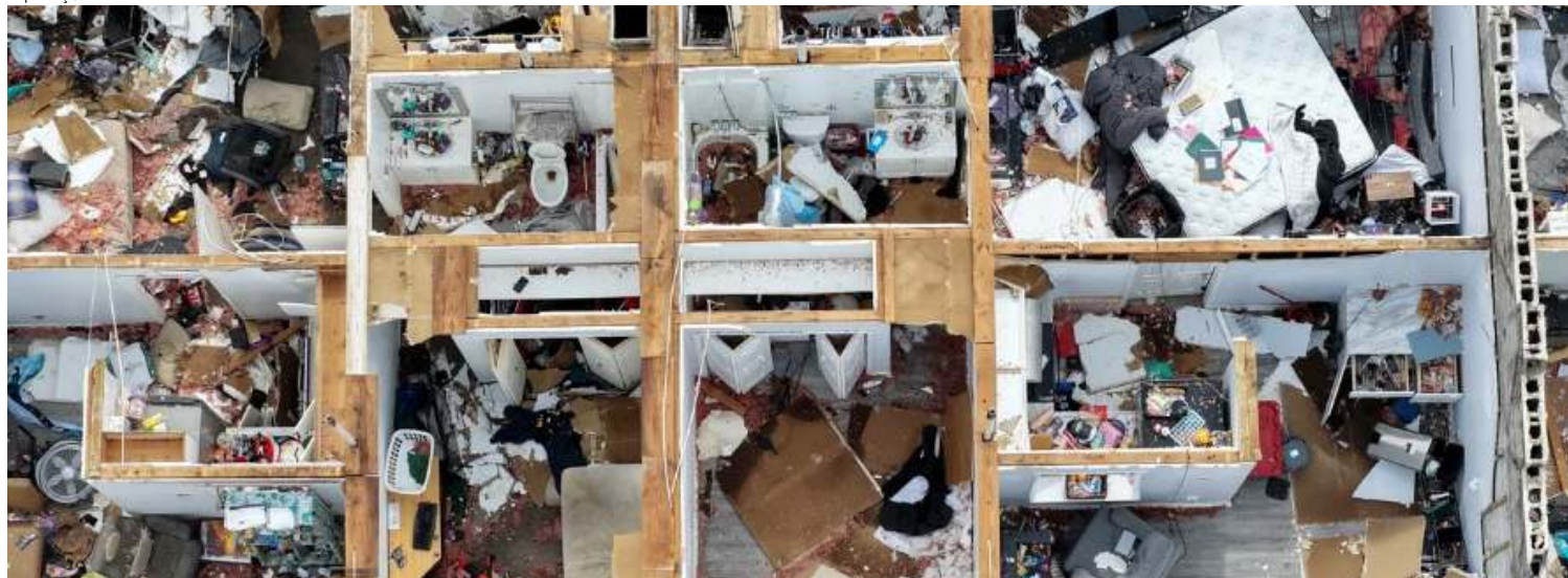
Telhado de um complexo de apartamentos foi arrancado pela força dos ventos do furacão Isaías em Milton, na Flórida.
