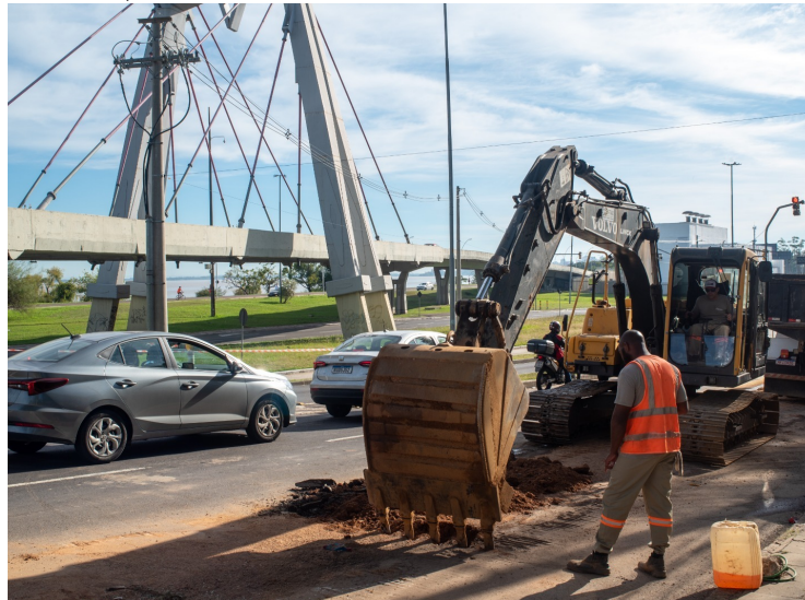
Trecho afetado é próximo ao Viaduto Abdias do Nascimento.
