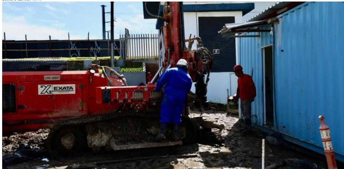
Projeto, com investimento de R$ 202 milhões, abrange 18 casas de bombas de drenagem urbana.
